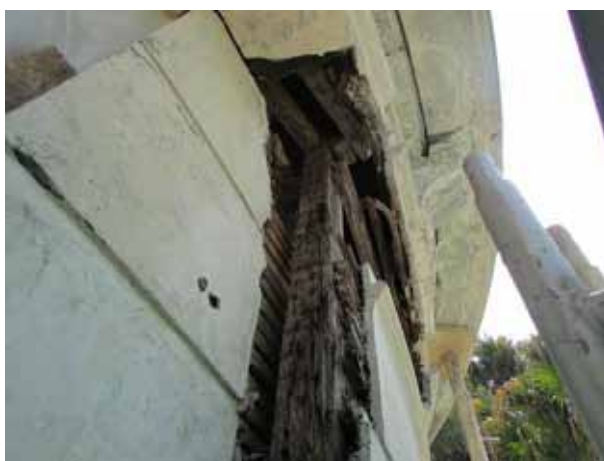
FIG. 1. Daños en estructura de madera por filtración de aguas lluvias provocando pudrición en Palacio Rioja.
