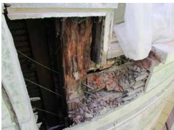
FIG. 2. Daños en revestimientos producto de rigideces distintas entre la estructura y el revestimiento cementicio (exterior) o yeso (interior)
