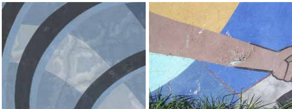
FIG. 3. Detalle de deterioros registrados en el mural La historia del movimiento obrero en la Magdalena Contreras de Arnold Belkin. 1981. Acrílico sobre concreto. Foro Cultural Juventino Rosas en la Delegación Magddalena Contreras, Cd. de México. Cortesía ALMG y SGJ.
