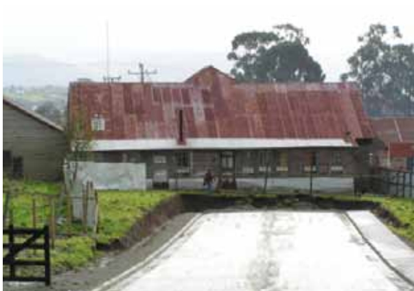
FIG. 1. Vista fachada posterior antes de la tiradura, con by pass ejecutado casi en su totalidad. (Inostroza, C. 2008)
