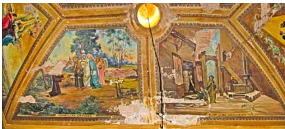
FIG. 4. Fotografía bóveda este de la sacristía – Patologías (Paz, O., 2009)
