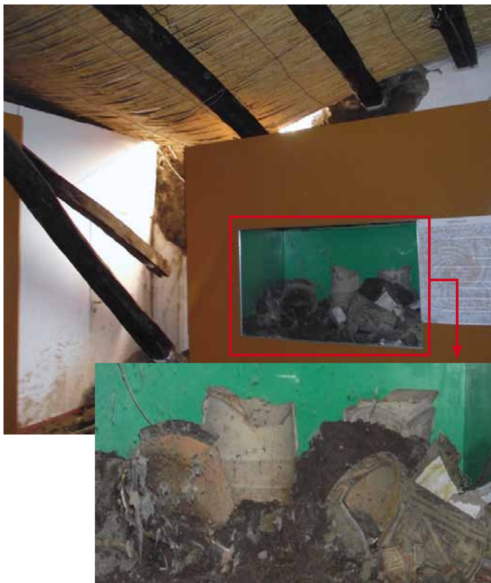
FIG. 2. En Enero del año 2014 debido a las intensas lluvias estivales colapsó parte del techo del Museo Arqueológico Eric Boman ubicado en la localidad de Santa María (Catamarca) dañando objetos arqueológicos en exhibición. El techo de la vieja casona que ocupa el museo está construido del modo tradicional, con cañizos y torta de barro, por lo que este material se filtró dentro de las vitrinas destruyendo algunos objetos de cerámica debido al impacto (fotos tomadas del Diario El Ancasti 02/20/14).
