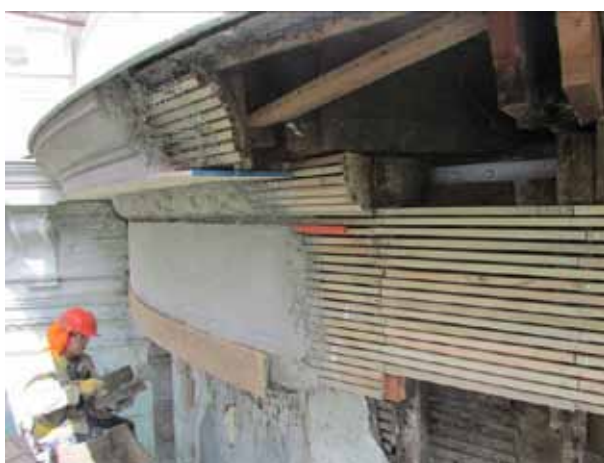
FIG. 4. Cornisa exterior con los distintos procesos de restauración.
