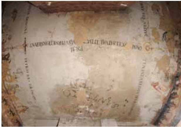
FIG. 2. Decoración mural, se puede apreciar el nivel de deterioro observándose inclusive el muro de piedra de la construcción de la cripta (Figuerola L. 2009)
