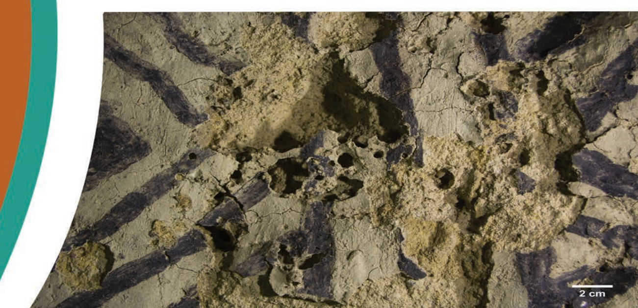
Falta de adherencia por galerías de insectos y ressecamiento.
