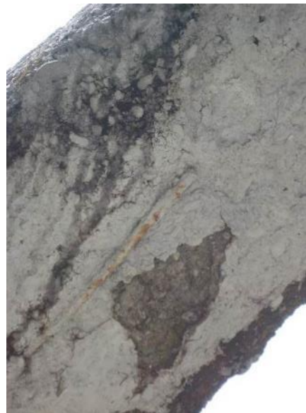
Fotografía 86. Mancha de oxidación que aflora en el concreto y varilla metálica visible en superficie y que presenta productos de corrosión de color naranja-rojizo
