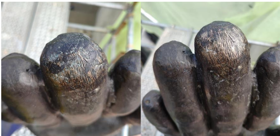
Fotografía 120 y 121. Eliminación de los productos de corrosión hallados bajo las intervenciones anteriores
