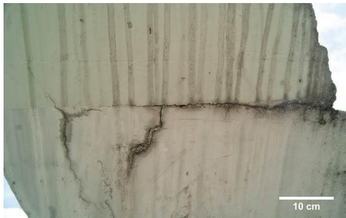
Fotografía 87. Fisuras presentes en la estructura por donde se favorece la entrada de agua en la estructura
