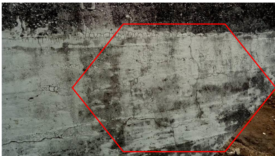
Fotografía 40. Mancha de oxidación que aflora en el concreto y varilla metálica visible en superficie y que presenta productos de corrosión de color naranja-rojizo
