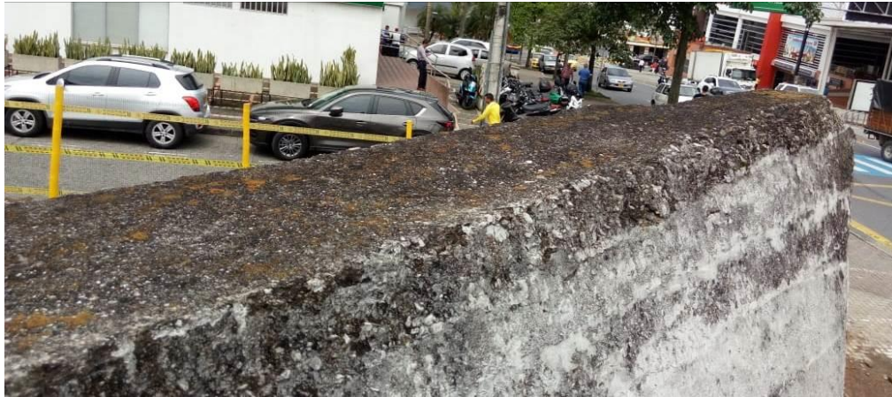
Fotografía 82. Última etapa de fundición del mortero con evidentes problemas de deterioro.
