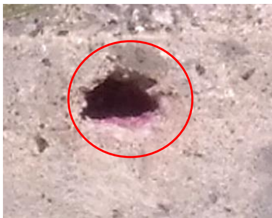
Fotografía 81. Imagen de la prueba de carbonatación con fenolftaleína.
