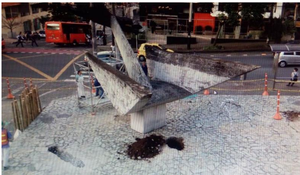
Fotografía 70. Las aristas expuestas en los elementos laterales y en la placa de coronación son las que presentan mayor acumulación de suciedad.
