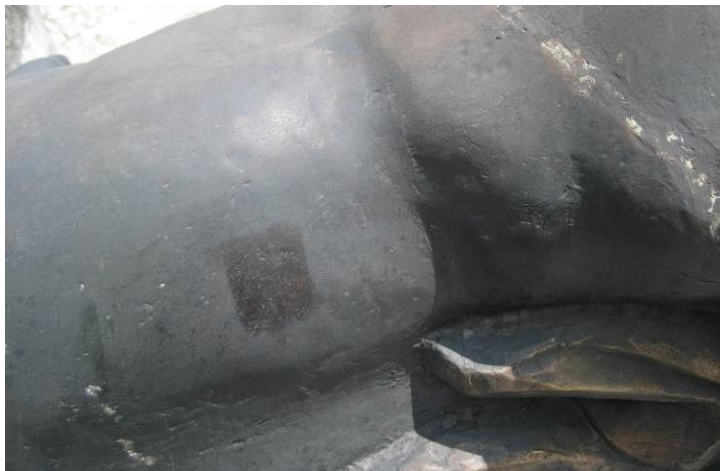
Fotografía 28. El recuadro muestra una zona en la cual se hizo una ventana de limpieza en seco con trapo de algodón, se hace evidente la gruesa capa de suciedad acumulada
