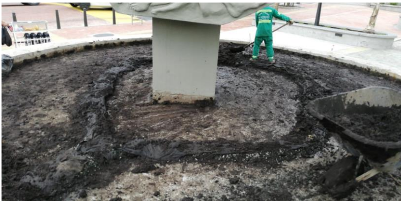
Fotografía 193 . Tierra en la jardinera con filtro
