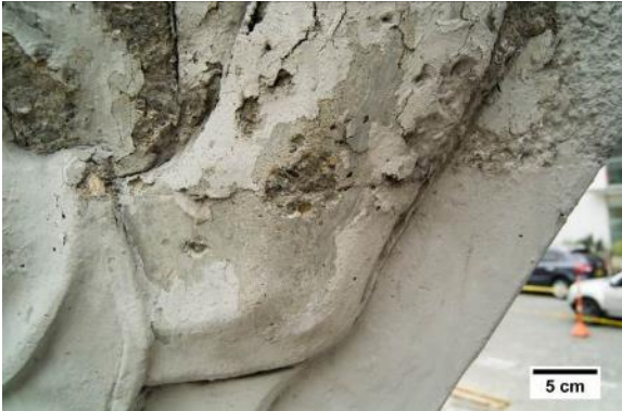
Fotografía 32. Evidencia de diferentes capas de pintura correspondientes a intervenciones anteriores
