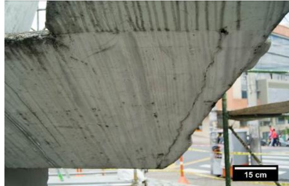
Fotografía 61. Se puede ver una línea horizontal - donde termina el cuerpo inferior del pedestal- de un color distinto, más claro con respecto a la zona superior del pedestal, lo cual evidencia intervenciones anteriores correspondientes a repintes.
