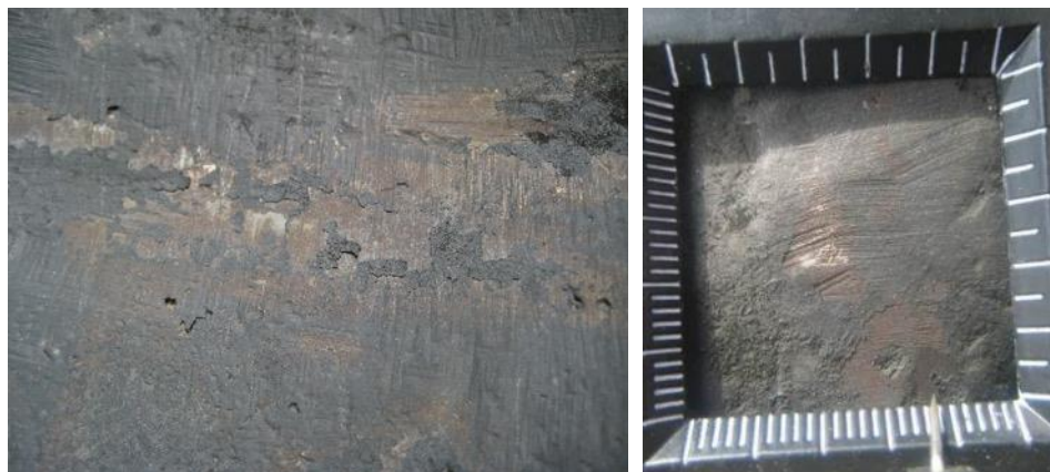
Fotografía 55 y detalle. Acercamiento a simple vista y con lupa de aumento 10x del recubrimiento que se usó en la zona de soldadura del torso. Se puede ver la diferencia entre éste y el recubrimiento homogéneo en el resto de la escultura.
