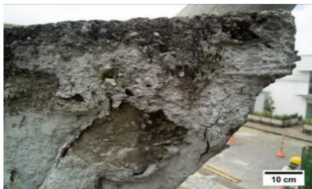
Fotografía 35. Pérdidas de masa de concreto como consecuencia de nivel avanzado de disgregación que presenta el mismo. Borde superior del trapecio occidental.
