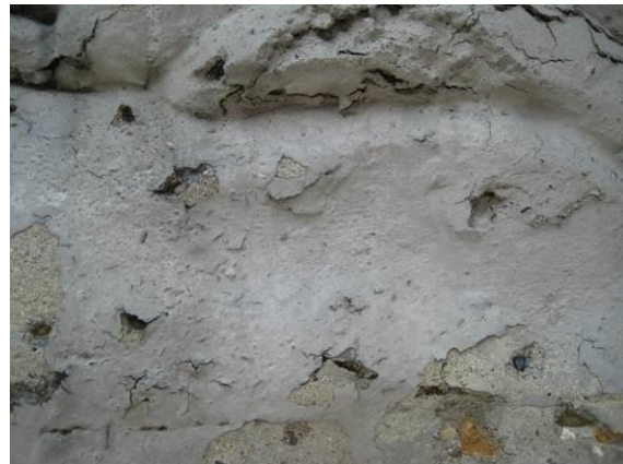
Fotografía 31. Ampollas presentes en estratos de pintura de intervenciones anteriores que evidencian separación de películas
