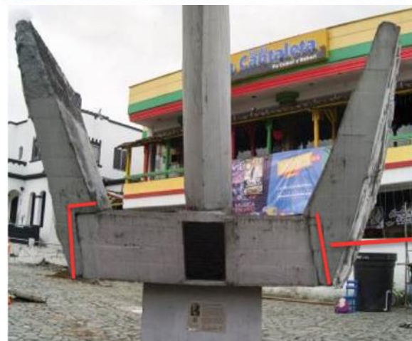
Fotografía 10. Frente. Junto a las líneas rojas se pueden ver las dilataciones testigo de la fundición de los elementos que conforman la estructura.
