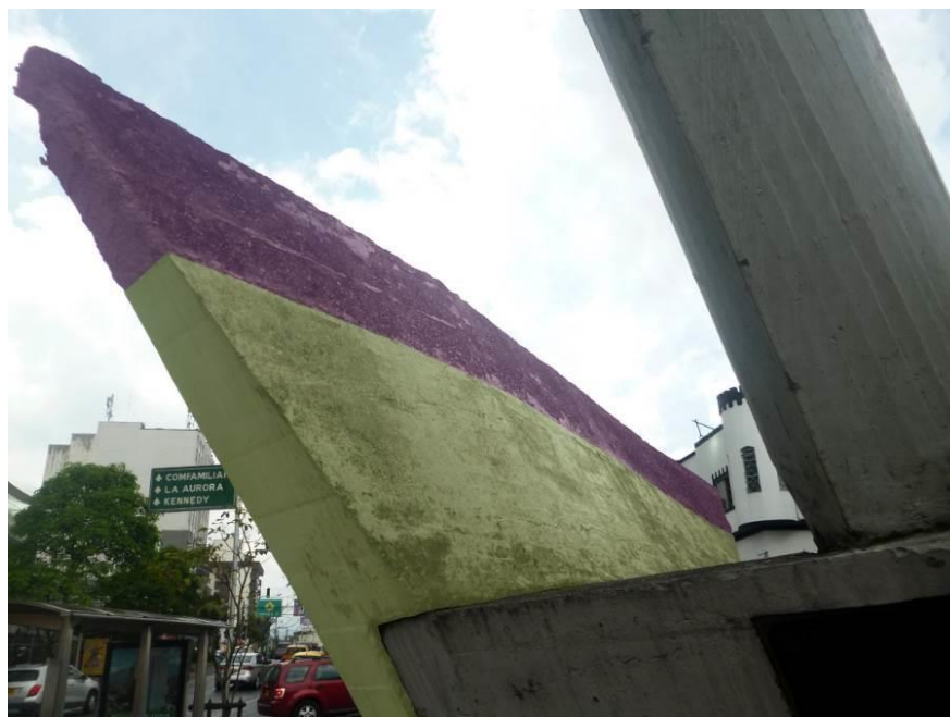
Fotografía 18. En rojo y amarillo zonas donde se diferencian etapas de fundición del concreto
