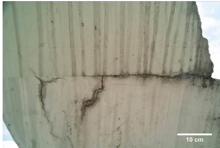
Fotografía 77. Manchas ocasionadas por escurrimientos de agua que arrastran suciedad y material particulado dejando una huella muy notoria en la superficie de la obra
