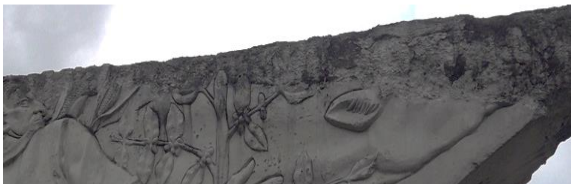
Fotografía 36. Pérdidas de masa de concreto como consecuencia de nivel avanzado de disgregación que presenta el mismo. Borde superior del trapecio oriental
