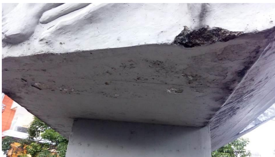
Fotografía 80. Síntomas de excesiva permeabilidad del concreto y evidencias de desprendimiento parcial del recubrimiento del acero.
