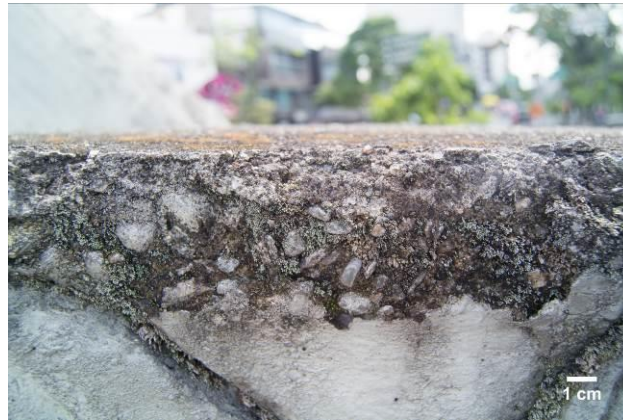
Fotografía 81. Acercamiento a zonas erosionadas donde se pueden ver elementos que componen la estructura del mortero y pérdida de acabado de superficie.
