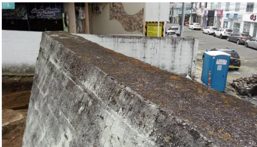
Fotografía 71. Las áreas más expuestas a la humedad permanente son las que presentan mayor colonización de microorganismos
