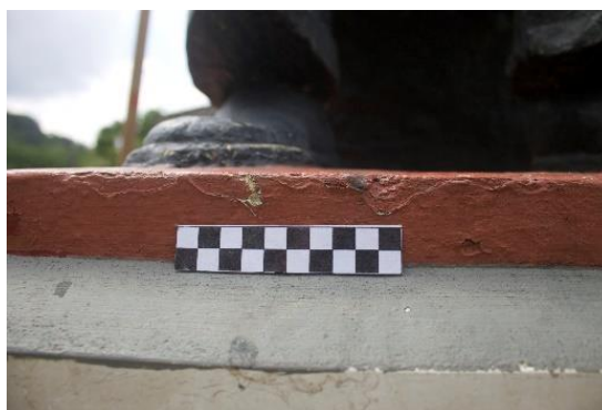
Fotografía 25. Faltantes superficiales en bordes de peana.
