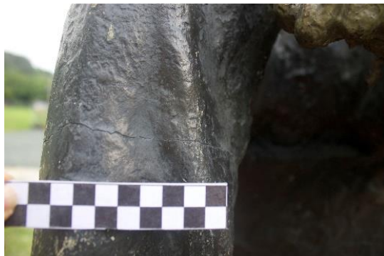
Fotografía 26. Grieta ubicada en piernas debajo de ambas rodillas.
