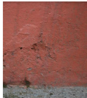
Fotografía 20. Escurrimientos sobre lateral de peana.
