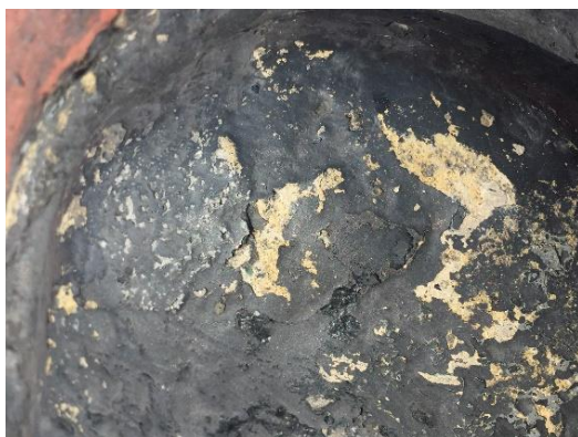
Fotografía 28. Faltantes de pintura en asiento de la escultura.
