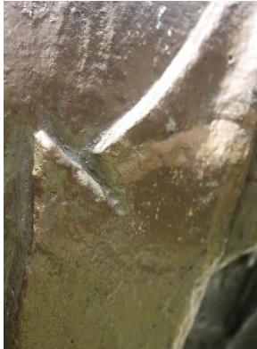
Fotografía 17. Acumulación de material particulado en de detalles de escultura.
