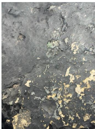
Fotografía 33. Faltantes en asiento que deja ver el soporte de cemento amarillo y repintes gris y verdes.
