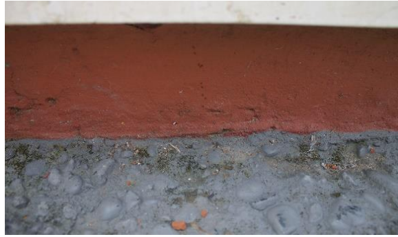
Fotografía 18. Acumulación de suciedad en pedestal.
