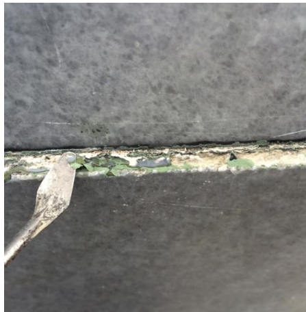
Fotografía 26. Restitución de juntas con espátula.
