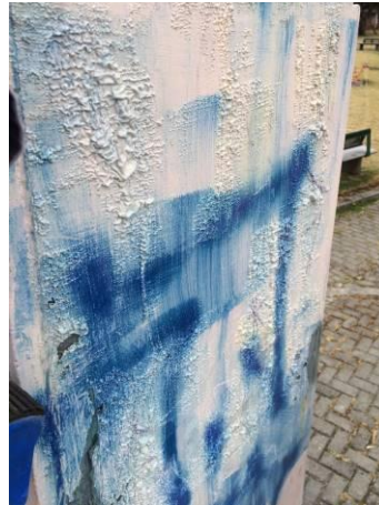
Fotografía 18. Levantamiento de pintura acrílica sobre el pedestal.
