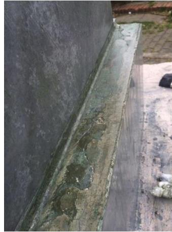
Fotografía 23. Faltante de laja de mármol.
