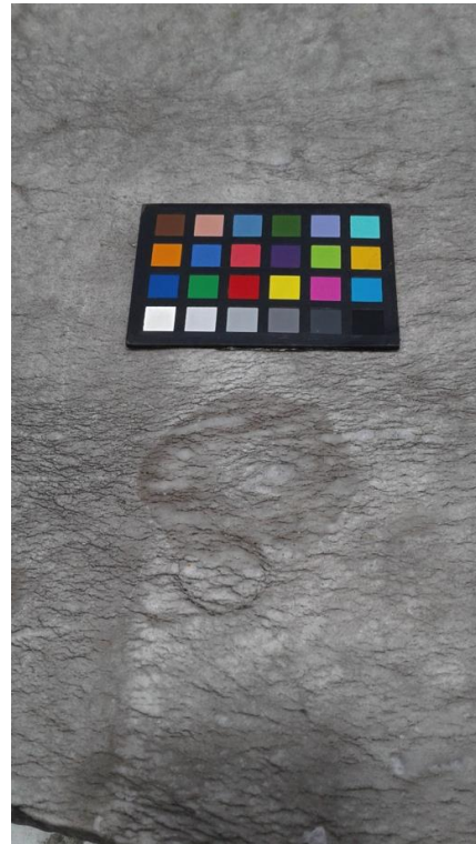
Foto 6: Se observa el diámetro de mojado que se formó durante el estudio en el punto de medición 1. Este informa sobre el transporte del agua dentro de la estructura pétre.
