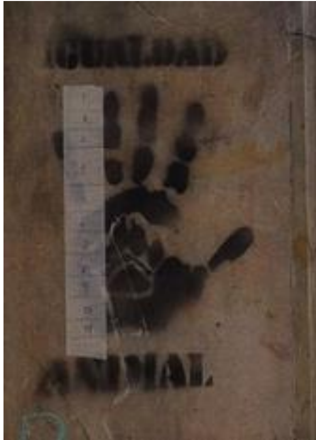
Fotografía 36. Prueba 6 antes de la limpieza
