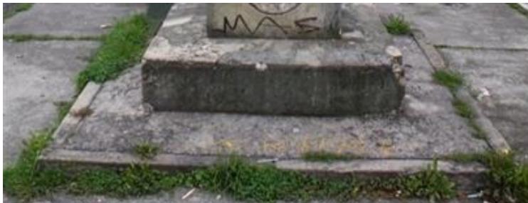
Fotografía 68. Basamento inferior antes de la intervención.
