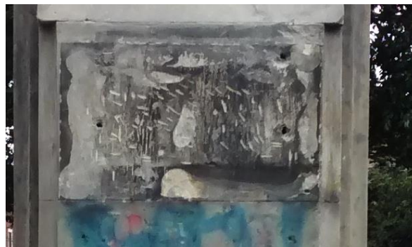
Fotografía 45. Pedestal sin placa. 4 puntos de anclaje de la placa anterior
