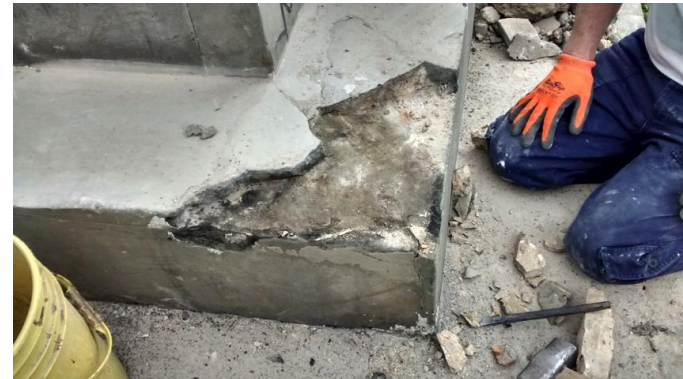
Fotografía 57. Resane completamente eliminado.
