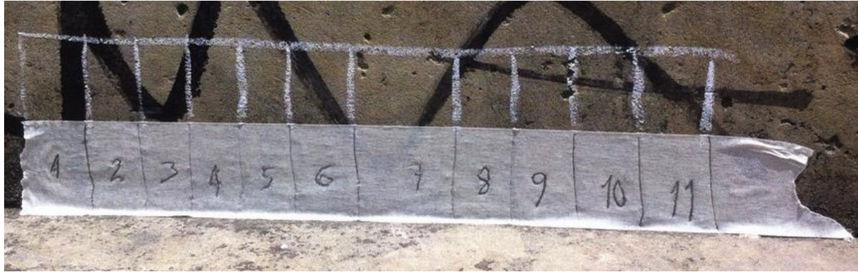
Fotografía 33. Prueba 5 antes de la limpieza
