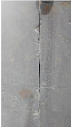
Fotografía 52. Juntas sin resane
