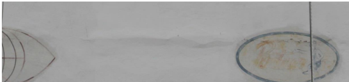
Imagen 38. Detalle del abombamiento del pañete de cemento en la parte baja del mural Cundinamarrum.
