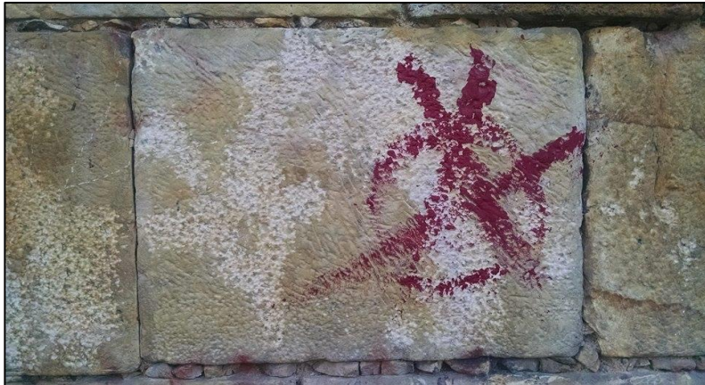
Figura 3: Área L3, Fotografía que registra el estado de conservación antes de las pruebas de limpieza.
