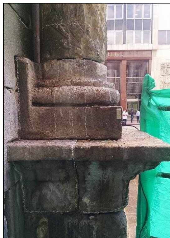
Figura 6: Área L6, Fotografía que registra el estado de conservación antes de las pruebas de limpieza.
