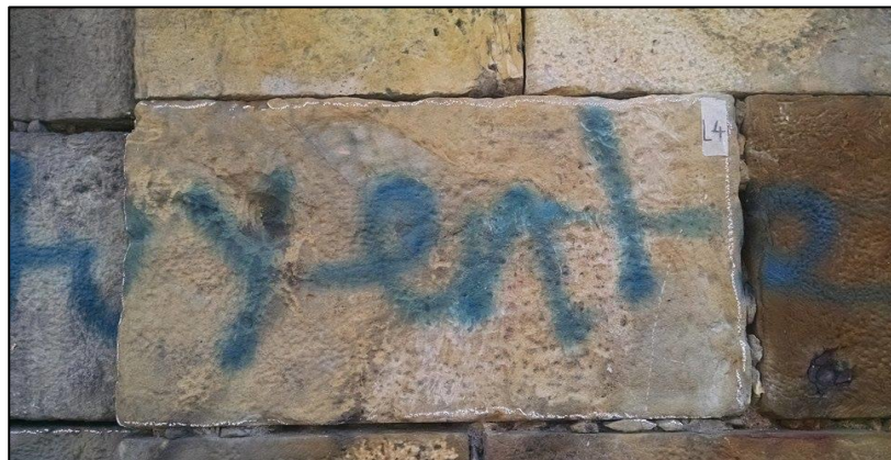
Figura 4: Área L4, Fotografía que registra el estado de conservación antes de las pruebas de limpieza.
