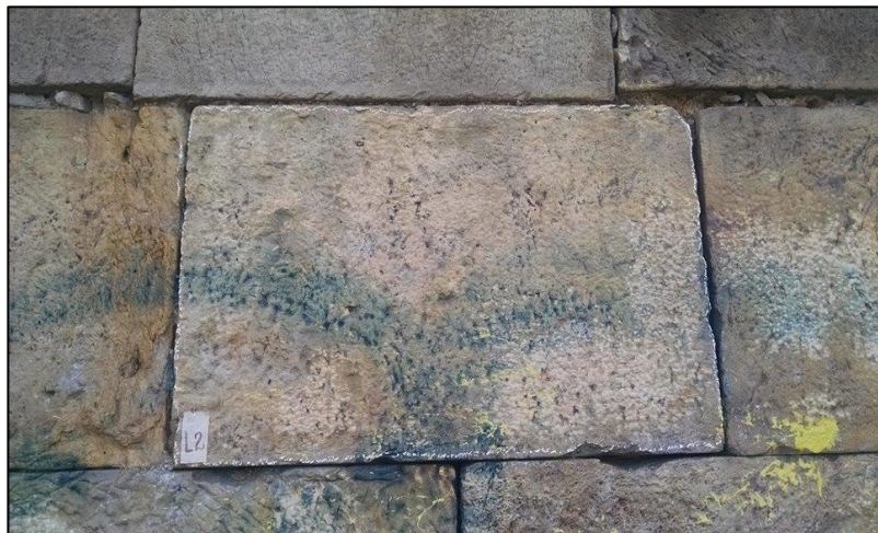
Figura 2: Área L2, Fotografía que registra el estado de conservación antes de las pruebas de limpieza.
