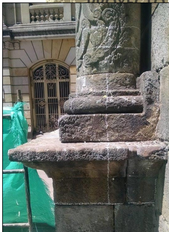
Figura 5: Área L5, Fotografía que registra el estado de conservación antes de las pruebas de limpieza.
