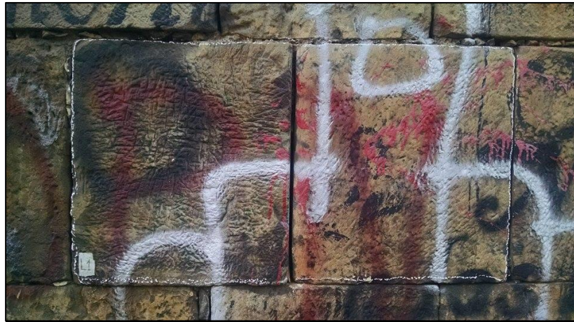
Figura 1: Área L1, Fotografía que registra el estado de conservación antes de las pruebas de limpieza.
