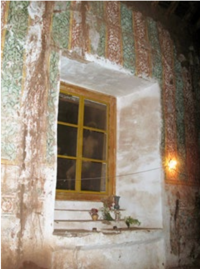
FIGURA 3.13 Vista de la grieta estructural a lo largo del vano sellado en el muro de la Epístola (norte). Foto: Clemencia Vernaza, 2013.
