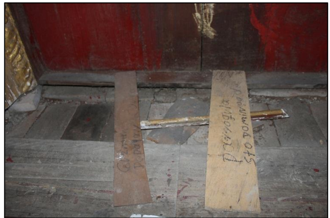
Foto 23. Estado actual del piso, correspondiente al nicho en el retablo de San Vicente de Ferrer
