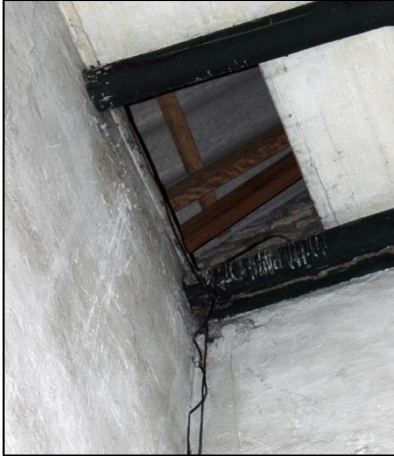
Foto 27. Filtraciones sobre mezzanine
