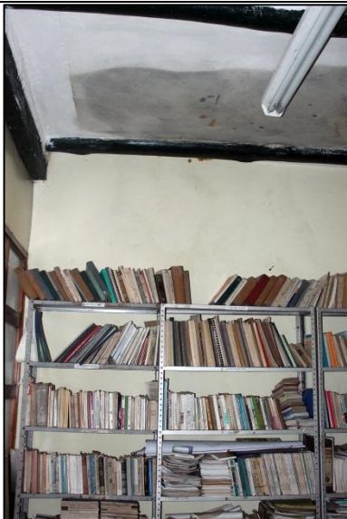
Foto 33. Humedad en cielo raso sobre estantería.
