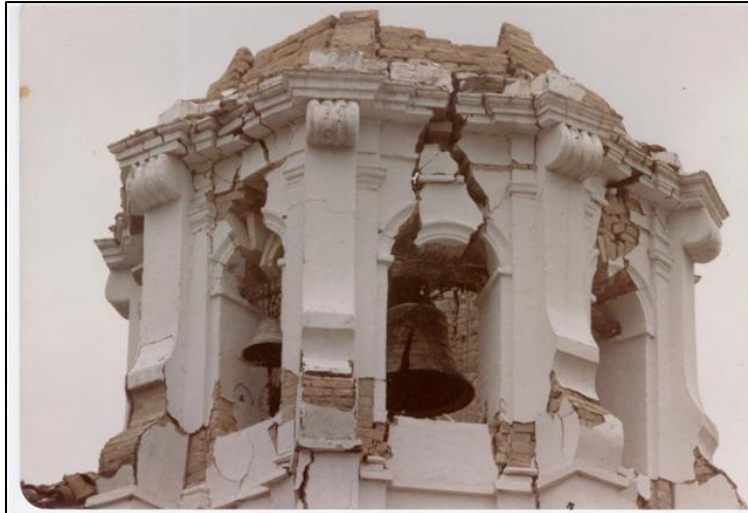
Foto 56. Estado del campanario de Santo Domingo después del terremoto de 1983 9
