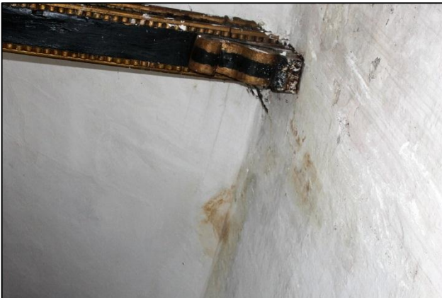
Foto 20. Filtraciones en el techo afectando los tirantes que forman la artesa de la nave central
