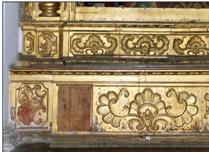
Foto 45. Faltantes de apliques y manchas en retablo Santo Cristo
