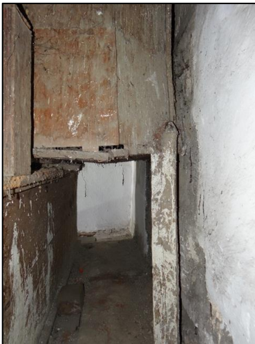
Foto 44. Retablo Santo Tomás de Aquino, reverso. Humedad en muro, suciedad (telarañas) 8
