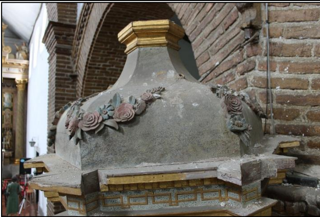
Foto 52. Tornavoz, suciedad acumulada y faltante del remate
