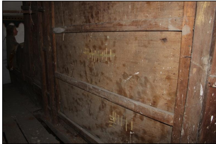
Foto 51. Reverso de la imagen de San Sebastián en el remate del retablo mayor. Presenta intervenciones en las zonas de fisuras
