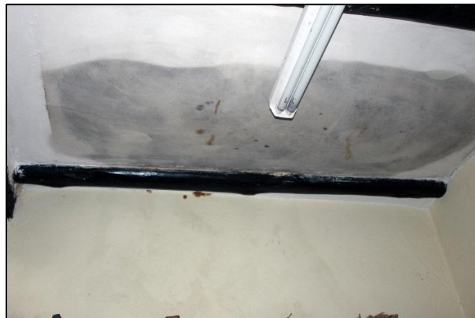
Foto 34. Humedad en cielo raso sobre estantería (acercamiento).
