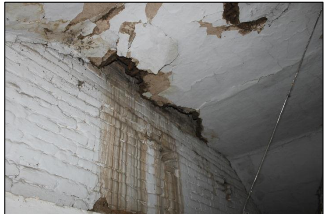
Foto 21. Filtraciones sobre el muro testero. Desprendimientos de revocos
