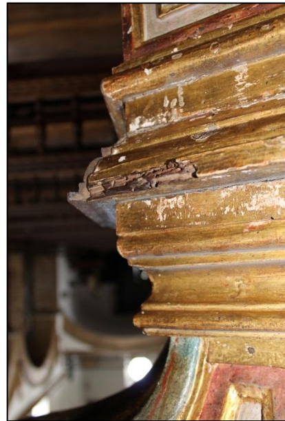
Foto 53. Presencia de insectos que han producido faltantes
