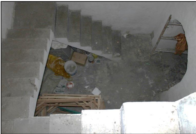
Foto 23. Estado actual acceso al campanario
