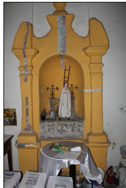
Foto 34. Estado actual del lavabo en la sacristía
