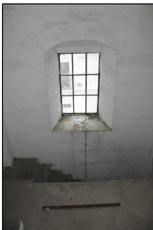
Foto 22. Ventana rota hacia el campanario
