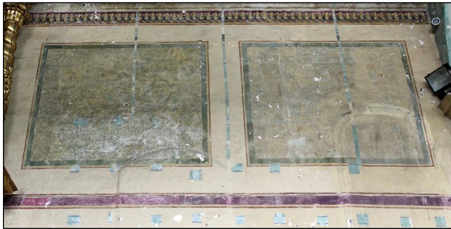
Foto 37. Estado de la pintura mural, muro sur presbiterio
