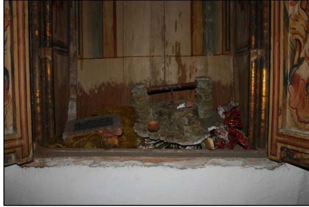
Foto 31. Estado actual de nicho. El interior es usado como depósito y falta la imagen.
