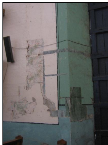
Foto 55. Fragmentos de pintura mural en la nave, muro sur en el 2008
