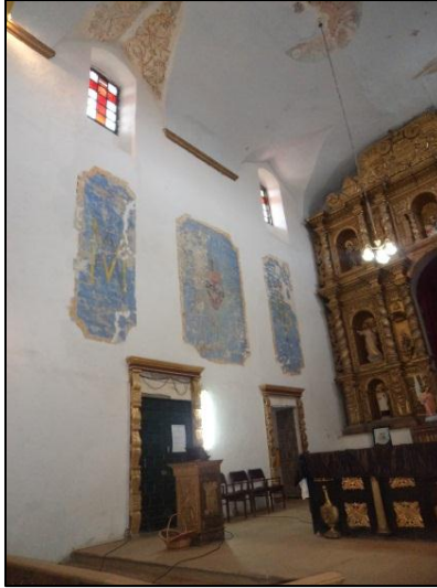
Foto 57. Estado actual de la pintura mural en muro norte del presbiterio
