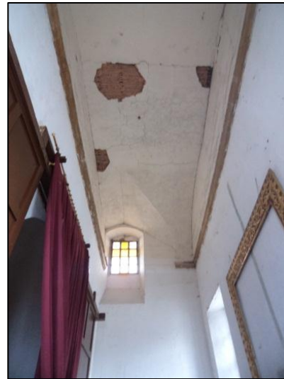
Foto 39. Camarín, problemas de filtraciones y desprendimientos del revoque.
