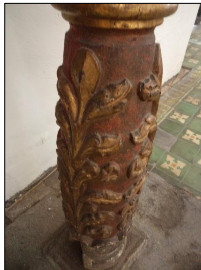
Foto 45. Problemas de conservación en la base del púlpito
