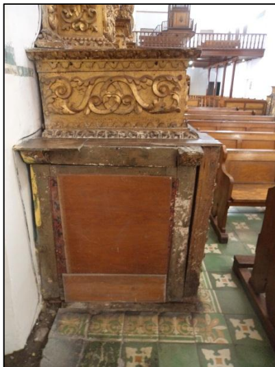
Foto 44. Faltantes e intervenciones en los retablos laterales
