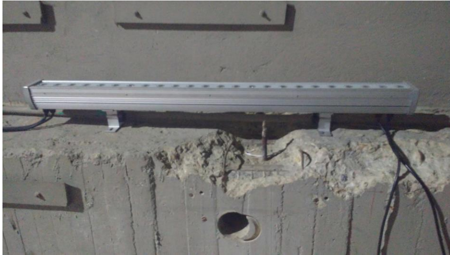
Fotografía 10. Luces ubicadas en los laterales del segundo piso.
