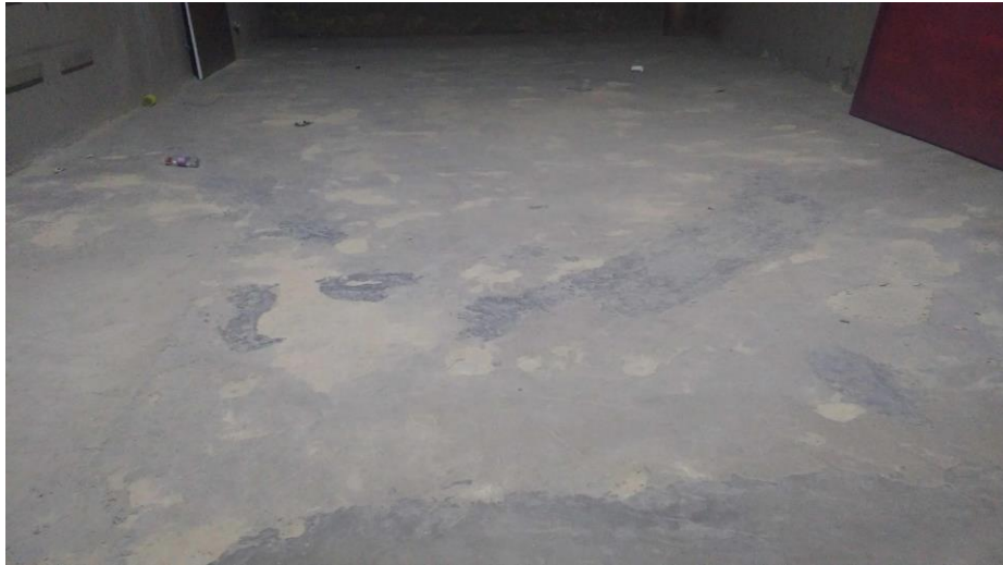
Fotografía 18. Desgaste del piso en la segunda planta.
