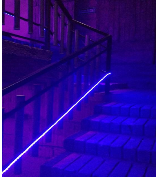
Fotografía 12. Sistema de iluminación de las escaleras.
