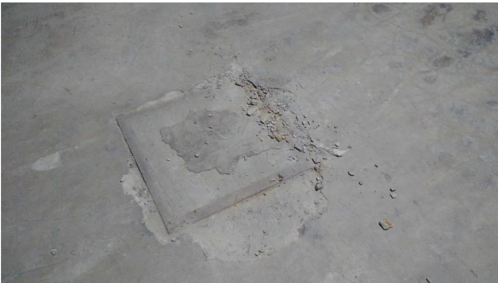
Fotografía 17. Desgaste de otra de las cajas de inspección ubicada en el primer piso.
