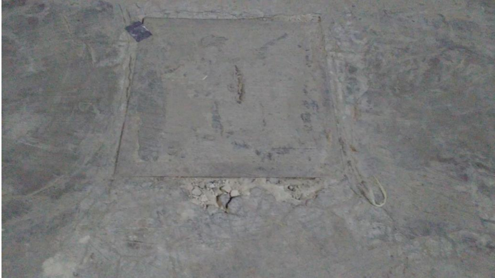
Fotografía 15. Desgaste en los bordes de una de las cajas de inspección ubicada en el primer piso
