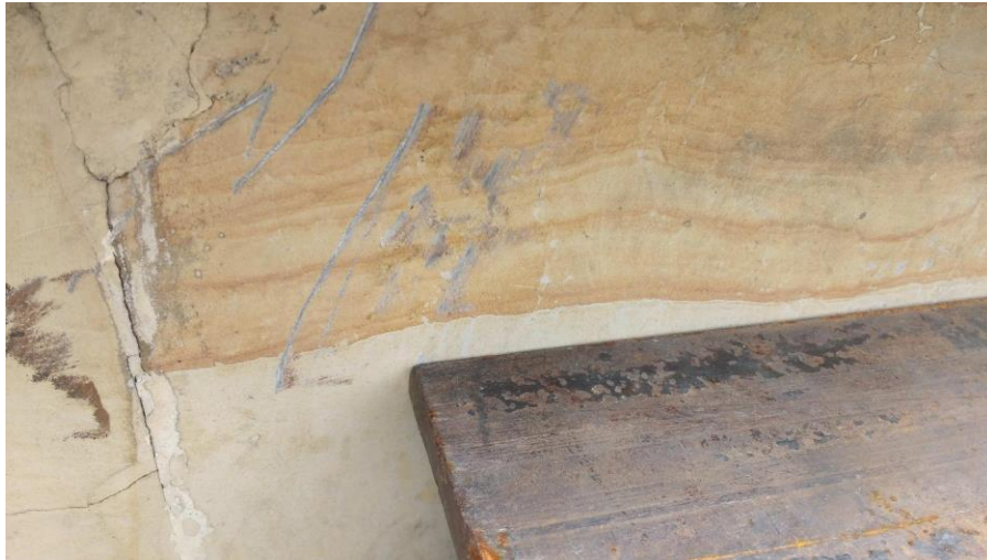
Fotografía 20. Rayones en la piedra generados por la estructura en H de hierro.
