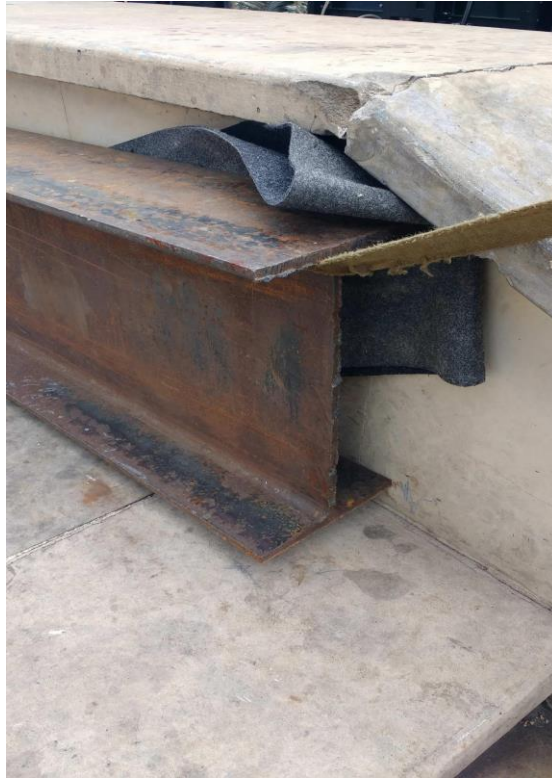
Fotografía 21. Retazos de alfombra ubicados entre la piedra y la estructura metálica.
