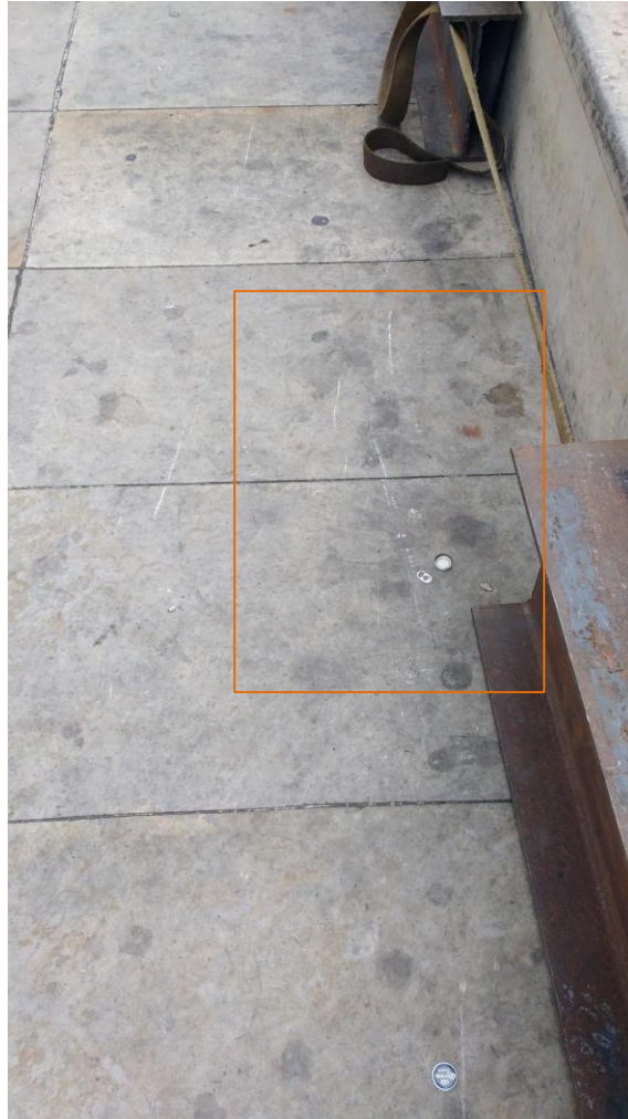
Fotografía 22. Rayones generados en el piso por las estructuras metálicas.
