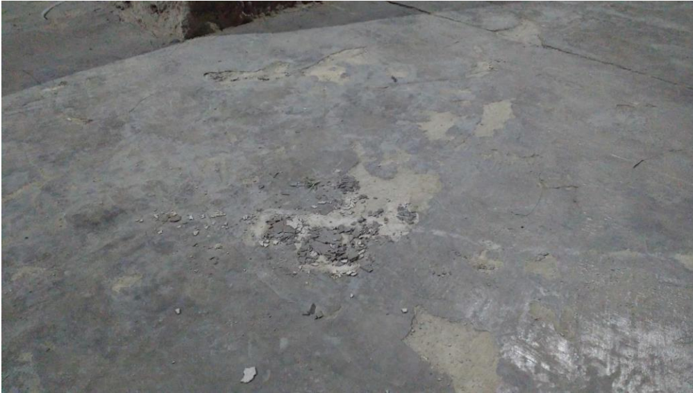
Fotografía 16 Desgaste del piso en el primer nivel.
