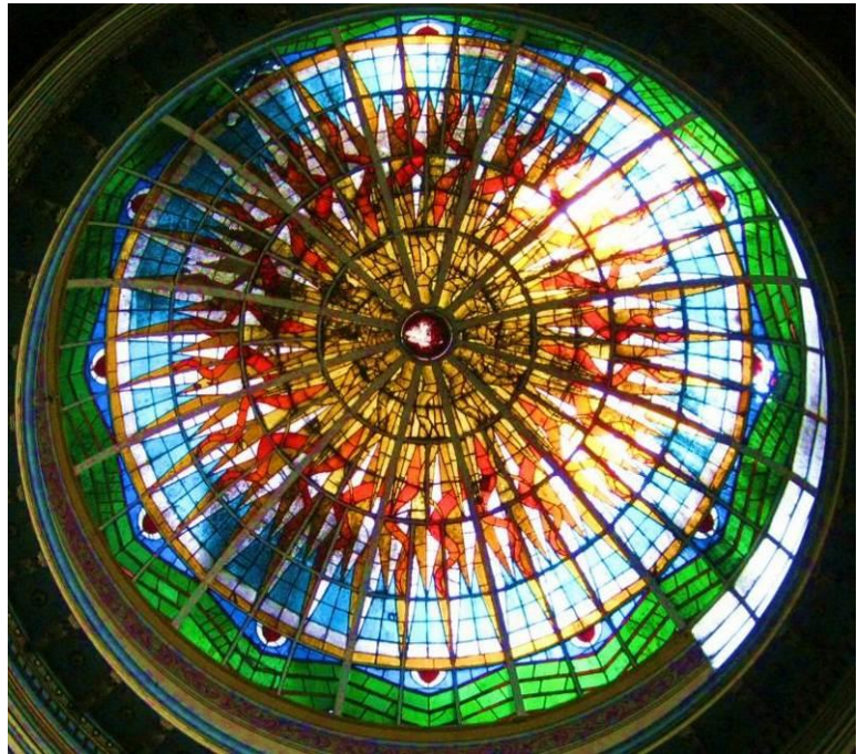
Vitral AV22 donde se aprecian a la derecha vidrios reemplazados
