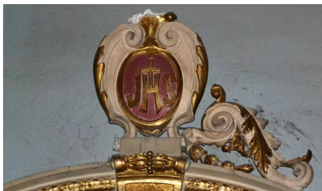
Faltantes relacionados con humedad en Anagrama AE52
