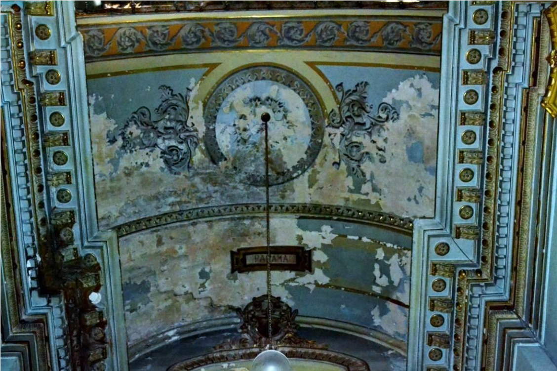
Avanzado deterioro de la pintura mural en la Capilla Panamá que muestra efflorescencias salinas, manchas de humedad, levantamientos y faltantes de capa pictórica
