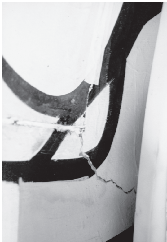
Detalle del mural Patricios y patricidas . Obsérvese la rotura que coincide en la unión de los bastidores de soporte. Foto: Archivo CNCRPAM/INBA.
